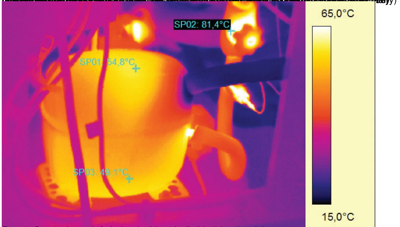
Fig. 2b. Termowizja wnętrza instalacji chłodniczej (chłodziwa: R410A, ciśnienie: 10,5 MPa, temperatura: 25°C)
