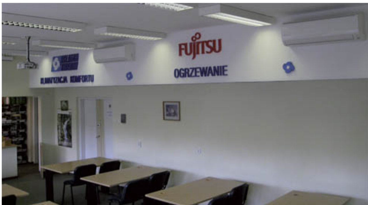
Jednostki wewnętrzne systemu FUJITSU MULTI 8 (typ ASYG18LFCA) w pomieszczeniu głównym czytelnicy Wydziału Inżynierii Środowiska Politechniki Warszawskiej
