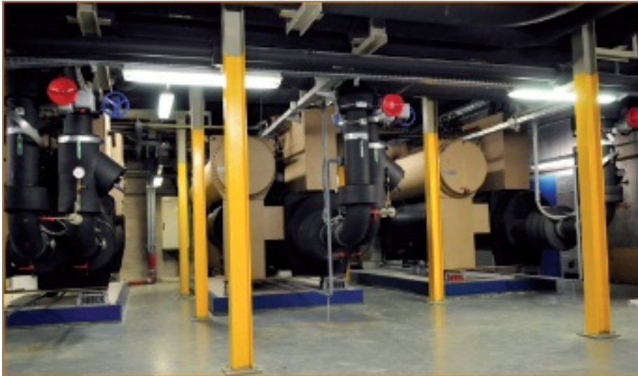
Fragment Maszynowni WCF z urządzeniami
